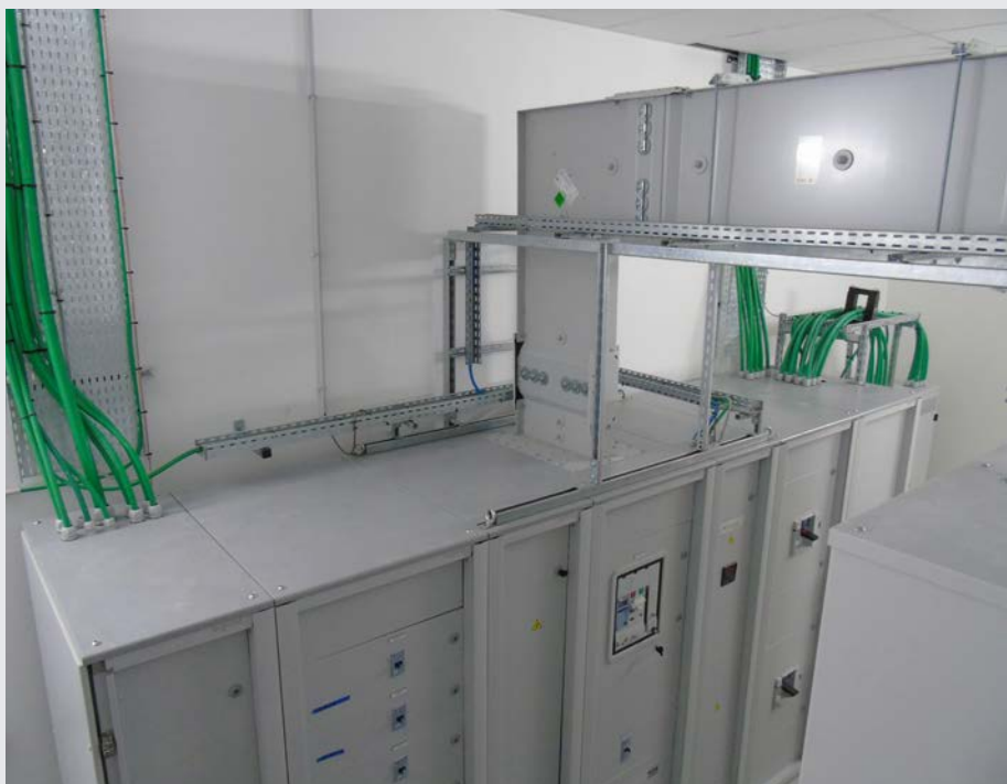
Esempio di distribuzione in condotto sbarre
