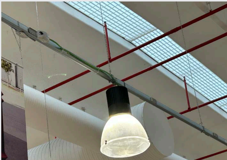
Esempio di distribuzione energia in condotto sbarre per illuminazione
